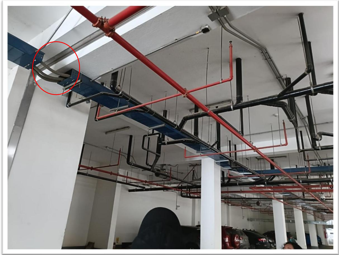
FOTO N° 09 En el primer nivel existen tuberías que pasan de un bloque a otro que no tienen junta flexible.
