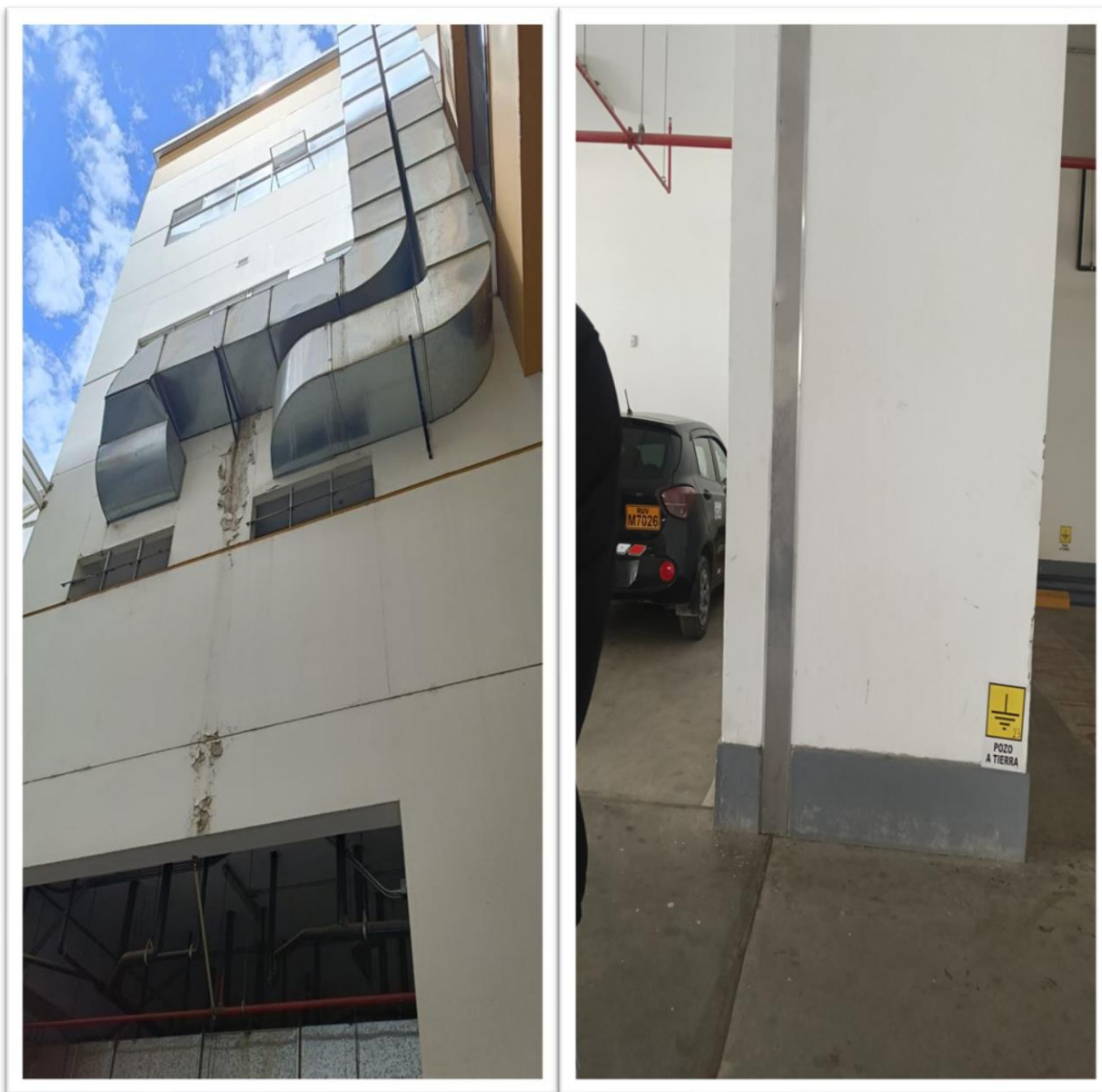
FOTO N° 07 Se evidencia pocas juntas de separación en edificios desde el cuarto nivel al último donde se encuentran pegados a estructuras metálicas.
