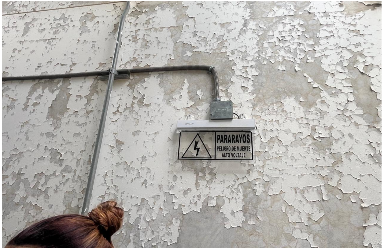
Fotografía 5: Los muros presentan desgaste y deterioro superficial.
