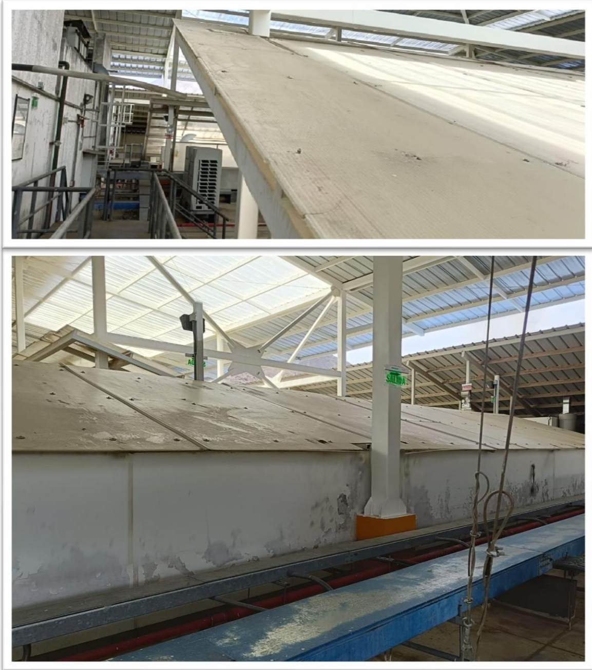
FOTO N° 01 Cobertura inicial en el último nivel que son de material de policarbonato ligero que presentan algunas ralladuras y falta de limpieza.
