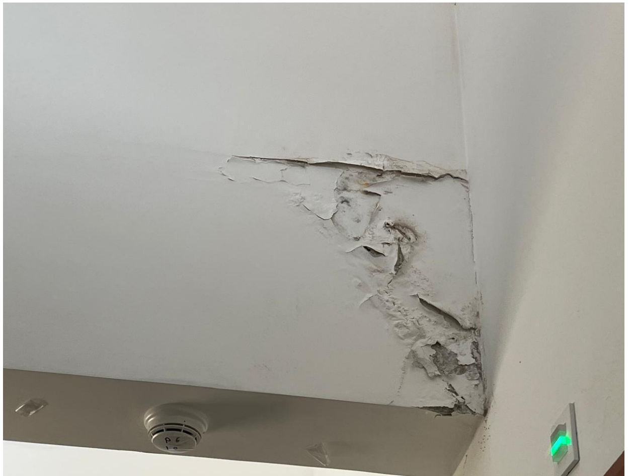
Fotografía 6: Se observa deterioro en las esquinas de algunos muros y columnas.
